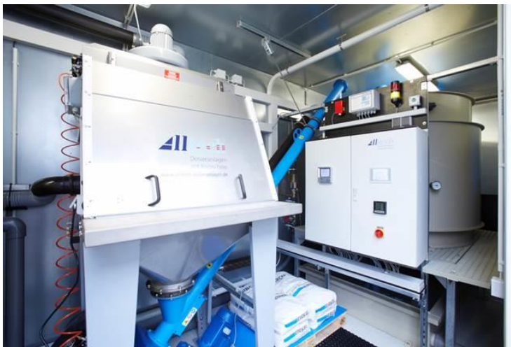
Die Demonstrationsanlage beim Bildungs- und Wissenszentrum Boxberg arbeitet auf der Grundlage des am KIT entwickelten Verfahrens P-RoC. (Foto: Andreas Räsch)
