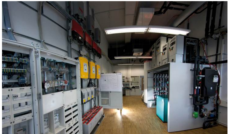
Blick ins SmartEnergyLab des Fraunhofer ISE. Die gelben Kästen beherbergen die dezentralen Agenten. ©Fraunhofer ISE
