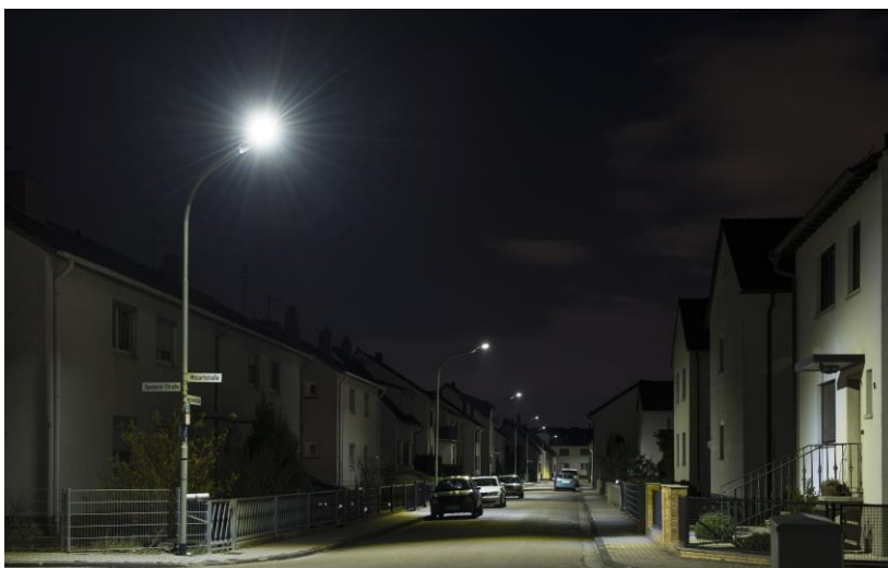
Die neuen Außenlampen, die in Maxdorf getestet werden, sparen nicht nur Strom, sondern strahlen auch deutlich heller. (Foto: Tanja Meißner/KIT).
