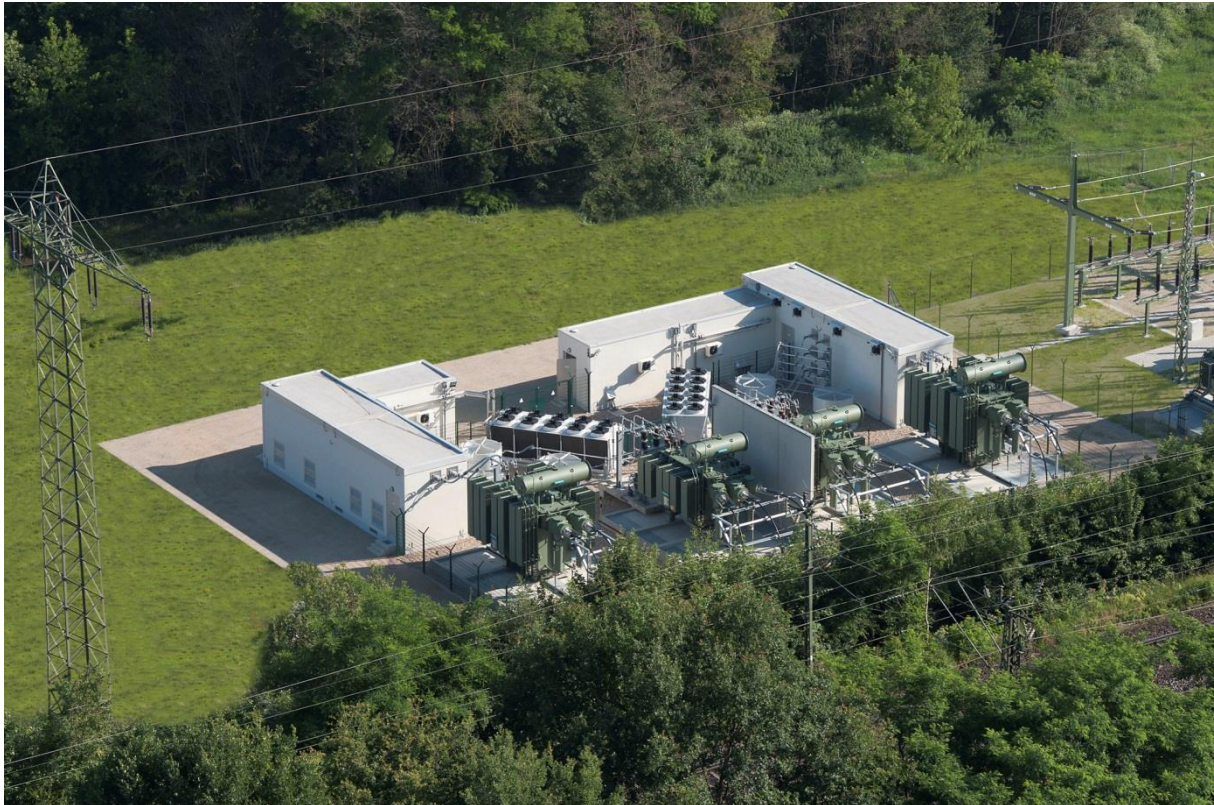
60 MW-Bahnstromumrichter in Multi-Level-Technologie zur Kopplung von 50 HZ-Hochspannungsnetz und 16 \frac{2}{3} Hz-Bahnnetz am Kraftwerk Franken in Nürnberg-Gebersdorf. Bildquelle: Siemens AG
