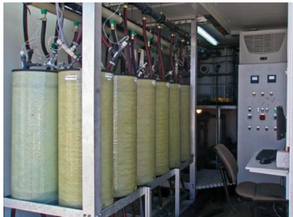
Pilotanlage auf Gran Canaria zur solarthermischen Meerwasserentsalzung auf Basis von Membrandestillation (Innenansicht). ©Fraunhofer ISE
