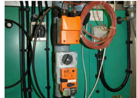
Das Ventil reguliert den Wasserdurchsatz des Wärmetauschers der Klimaanlage, damit dieser am optimalen Punkt arbeitet.
