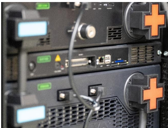
Abb. 2 Lithium-Ionen-Speicher in der Forschungsfabrik des Fraunhofer IWU. © Fraunhofer IWU
