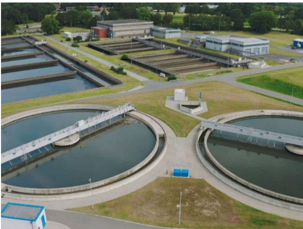
Abb. 3 Kommunale Kläranlagen: In der EU wird eine 4. Reinigungsstufe gestaffelt nach Größe bis 2045 verpflichtend.
