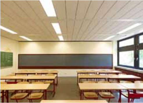
Abbildung 24: Typische Beleuchtungssituation in einem Klassenraum vor der Umrüstung auf LED © Philips GmbH
