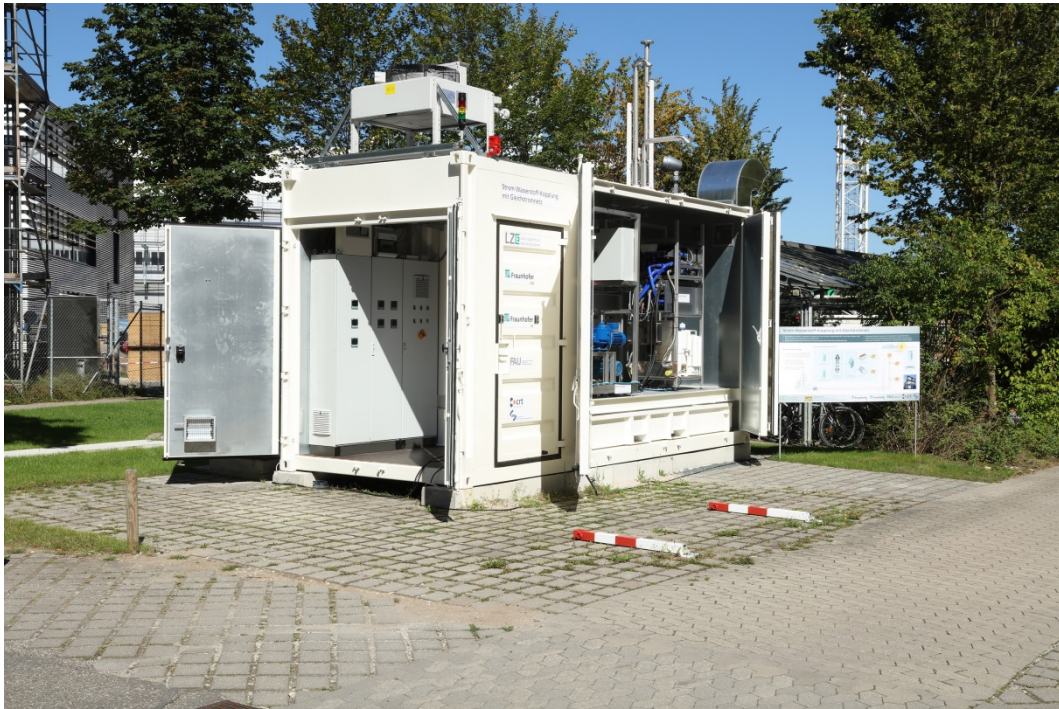
Der Container umfasst zwei getrennte Abteile: eines für die effiziente Anbindung ans elektrische Netz und die Steuerungstechnik (vorne links), das andere für den verfahrenstechnischen Aufbau (rechts). Foto: Kurt Fuchs / Fraunhofer IISB
