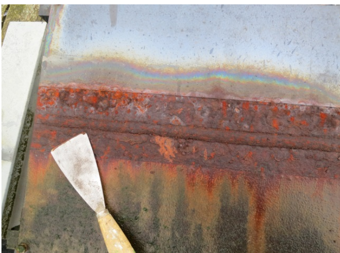
Bild 1: Prüfblech Seeauslagerung nach einjähriger Auslagerung (Zwischeninspektion)
