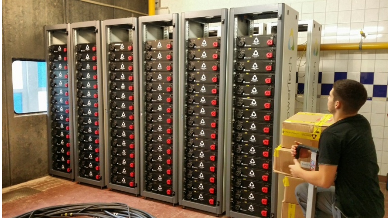
Installation des Batteriespeichersystems auf Borkum. ©Fraunhofer ISE
