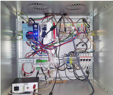
Aufbau des VREM-Kombinationssystems auf Basis der speicherprogrammierbaren Steuerung (Quelle: Fraunhofer IBP)
