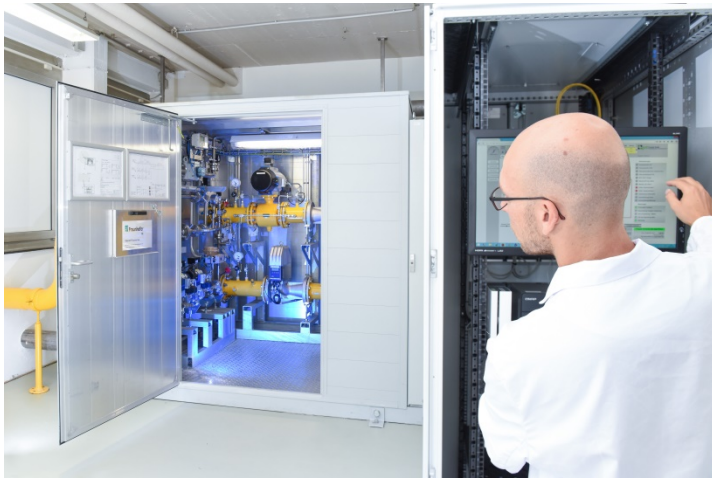
In einer Pilotanlage erprobt das Fraunhofer ISE bereits seit zwei Jahren die Wasserstoffeinspeisung in das Erdgasverteilnetz. © Fraunhofer ISE/Joscha Feuerstein
