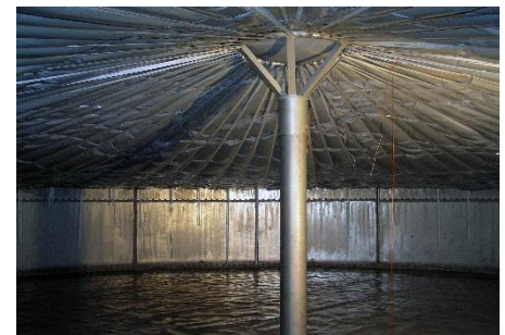
Innenansicht des Versuchsbehälters bei zum Teil abgelegter Gasmembran auf der Stützkonstruktion. (Foto: Rosemarie Wagner, KIT)
