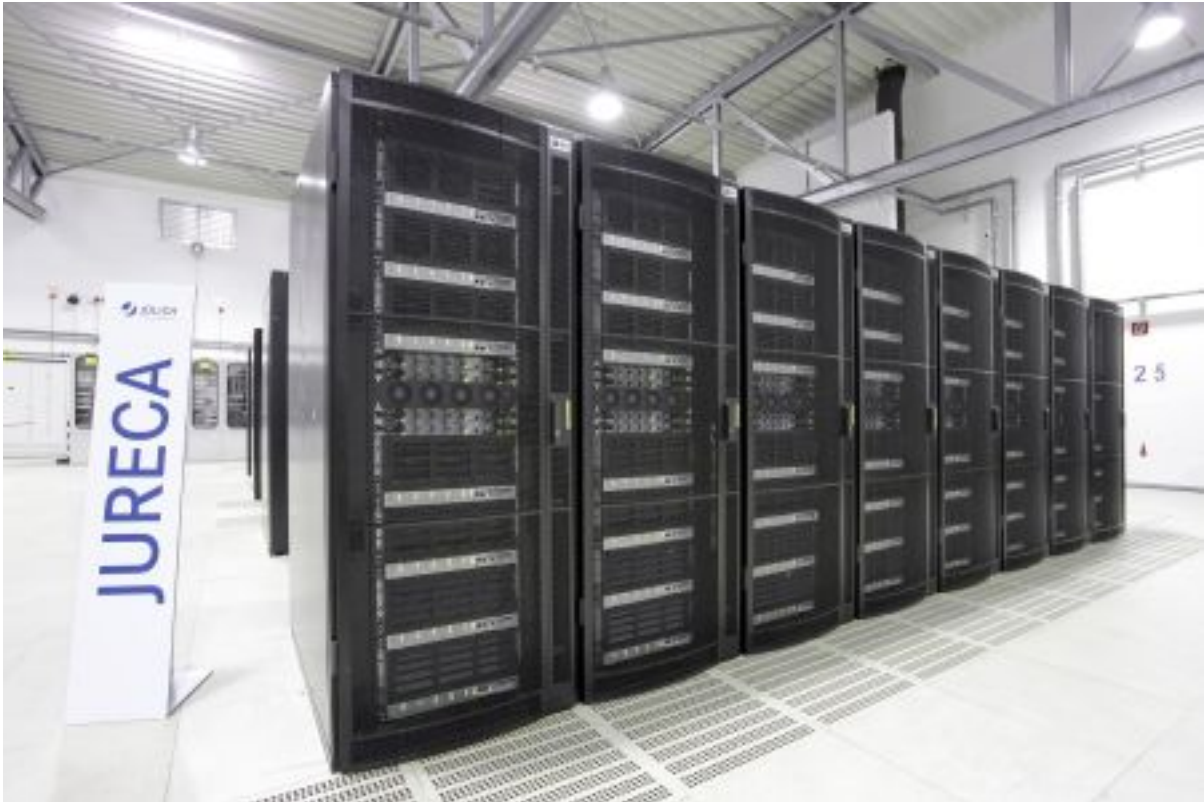
Supercomputer JURECA Copyright: Forschungszentrum Jülich
