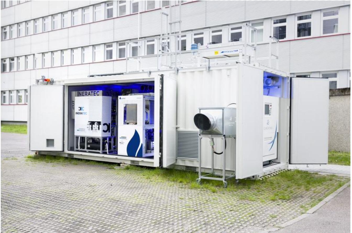
Weltweit erste integrierte Power-to-Liquid (PtL) Versuchsanlage zur Synthese von Kraftstoffen aus dem Kohlendioxid der Luft. (Foto: Projekt P2X) Projekt P2X
