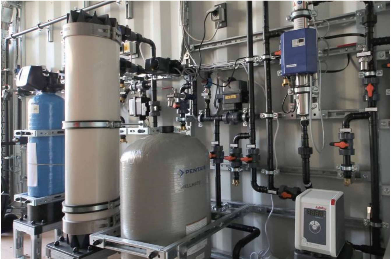
Acht Technologien zur Wasseraufbereitung, die einzelnen und auch miteinander kombiniert getestet werden, sind im Demonstrator verbaut INP
