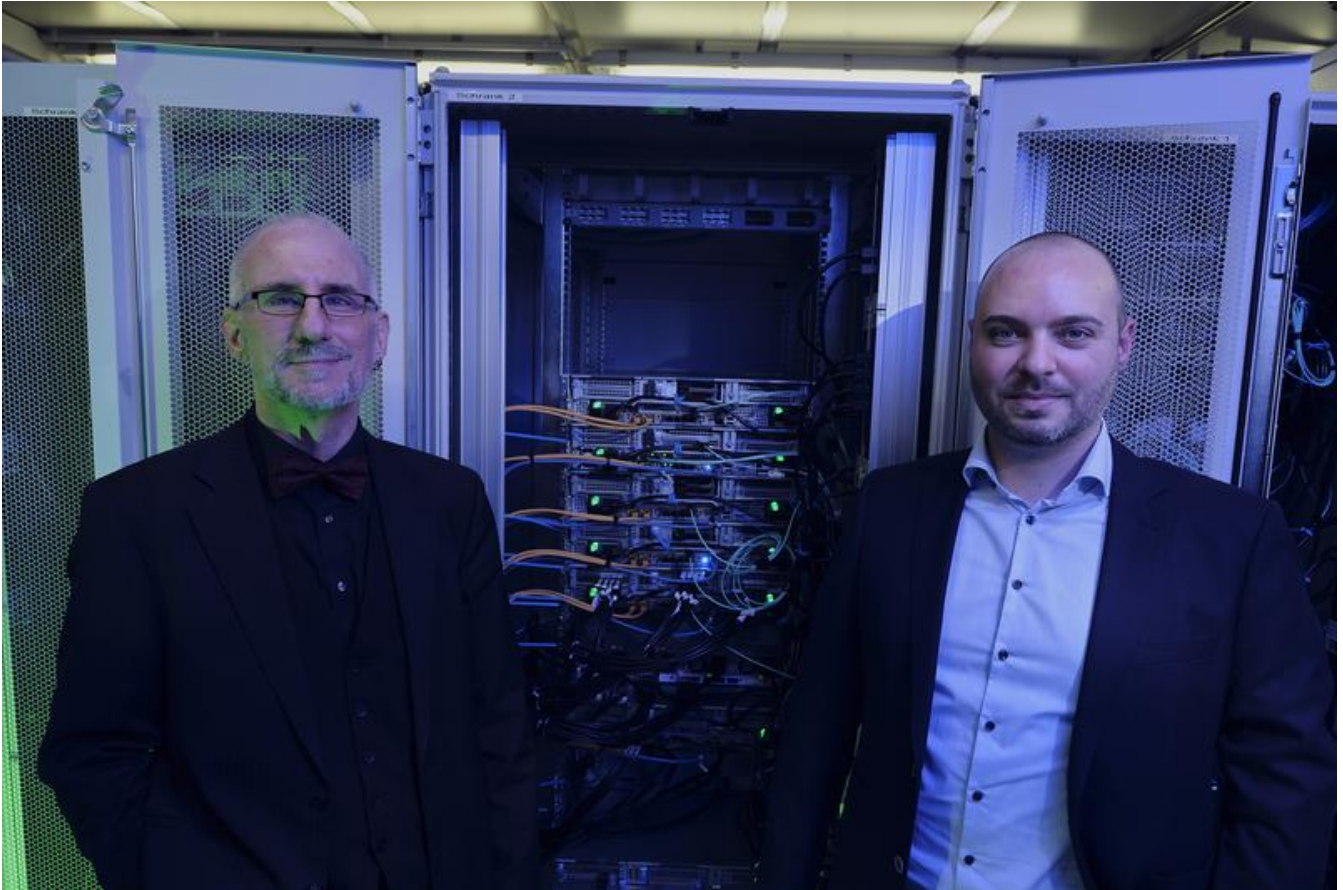
Dr. Matthias Fricke (l.) und David Pelkmann waren für den Einbau sowie die Installation von Hardware und Software von yourAI zuständig. K. Starodubskij/HSBI
