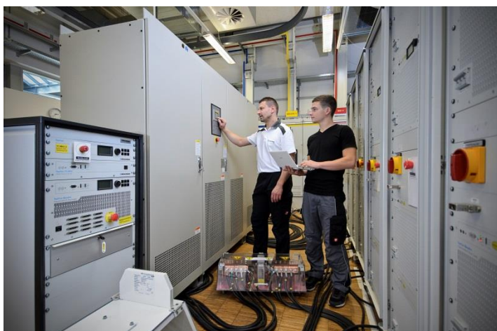
Im TestLab Power Electronics des Fraunhofer ISE werden Stromrichter aller Arten mit einer Leistung von bis zu 1 MW getestet und entwickelt. An einem neuen Laborstandort baut das Forschungsinstitut dieses Leistungsangebot nun in den Multi-MW-Bereich aus. ©Fraunhofer ISE
