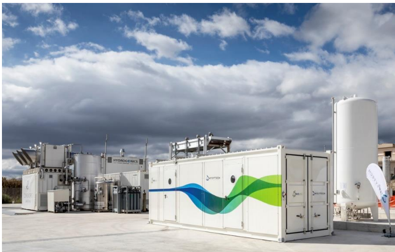
Die Demonstrationsanlage in Troia, Italien, kombiniert einen neuartigen Mikroreaktor für die Methanisierung mit einer innovativen Verflüssigungsanlage. Das erforderliche CO 2 wird aus der Umgebungsluft gewonnen. (Foto: Domenico Grossi)
