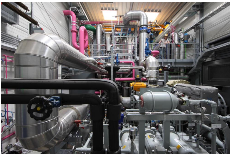
Ein Blick ins Innenleben der Geothermieranlage Bruchsal (Foto: EnBW/Uli Deck)
