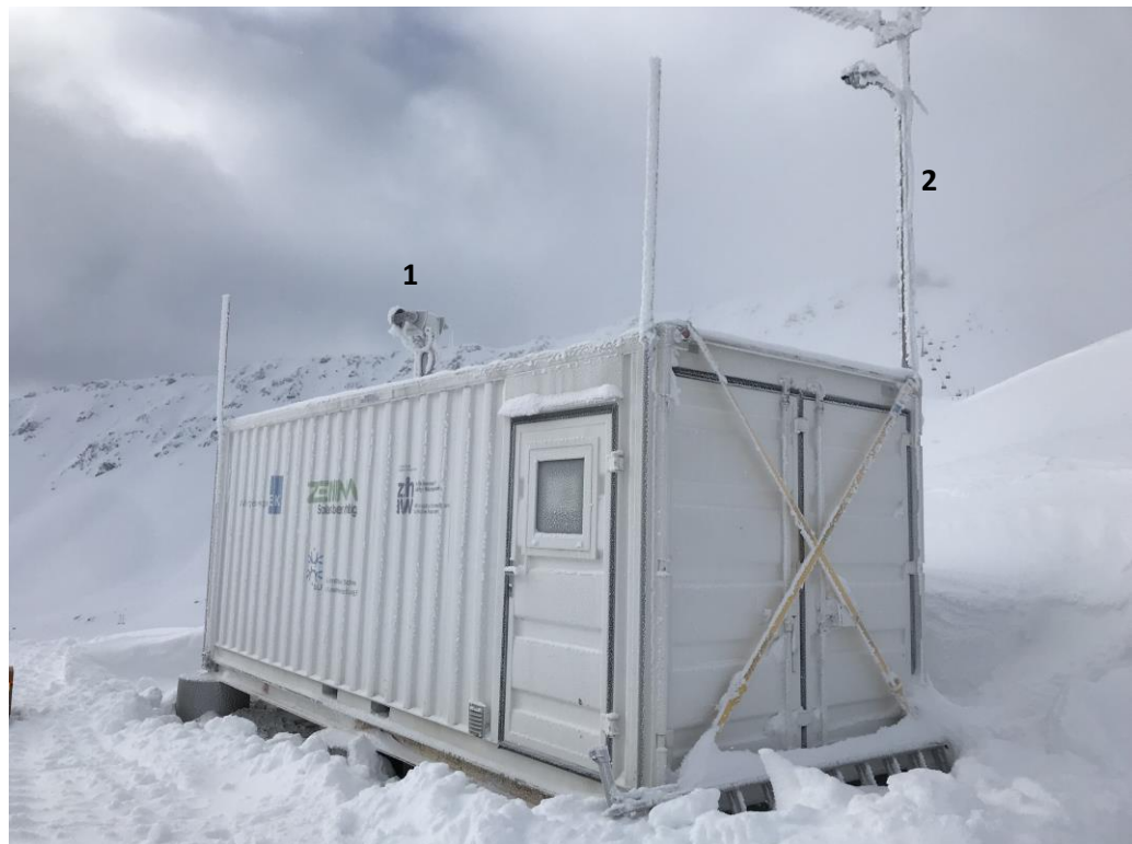
Abbildung 26: Messcontainer der PV-Versuchsanlage Totalp. Bietet Platz für die Energiemeter sowie die Installationen für den Betrieb und die Datenübertragung der Anlage. Auf dem Dach befindet sich ein zweiachsiger Tracker (1), auf der Seite befindet sich ein Mast (2) mit Mobilfunkantenne, Webcams und Pyranometern.
