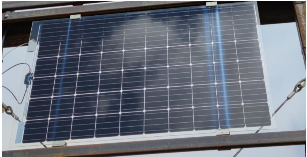
Abbildung 21: Ablagerungen auf den PV-Modulen im Segment 90° bifazial. Vermutlich entstanden durch eine Abtropfkante der Stahlkonstruktion und den Modulklemmen.
