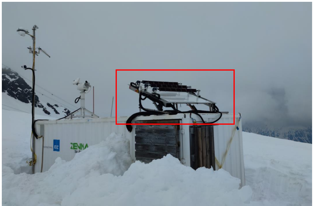
Abbildung 24: Verstellbare Mini-PV-Anlage (rot eingezeichnet) auf dem Containerdach der bestehenden Versuchsanlage in Davos Totalp.
