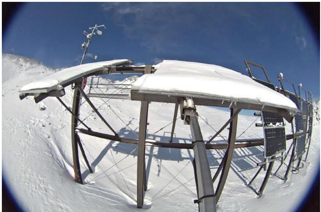
Abbildung 19: Schneebedeckung von PV-Modulen bei der Versuchsanlage Davos Totalp am 16. November 2019 nach nächtlichem Schneefall. Bei hoher Modulneigung (70° und 90° rechts im Bild) rutscht der Schnee schnell ab.
