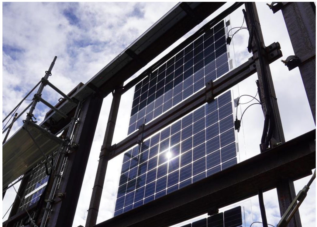
Abbildung 11: Die Segmente C und D wurden für die Montage von bifazialen PV-Modulen konzipiert. Die Verschattung der Rückseite der Module wird minimiert.
