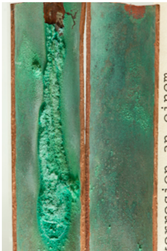
Lochkorrosion an einem Kupferrohr der Hauswasserleitung ("Lochfraß") DECHEMA/Rui Camilo
