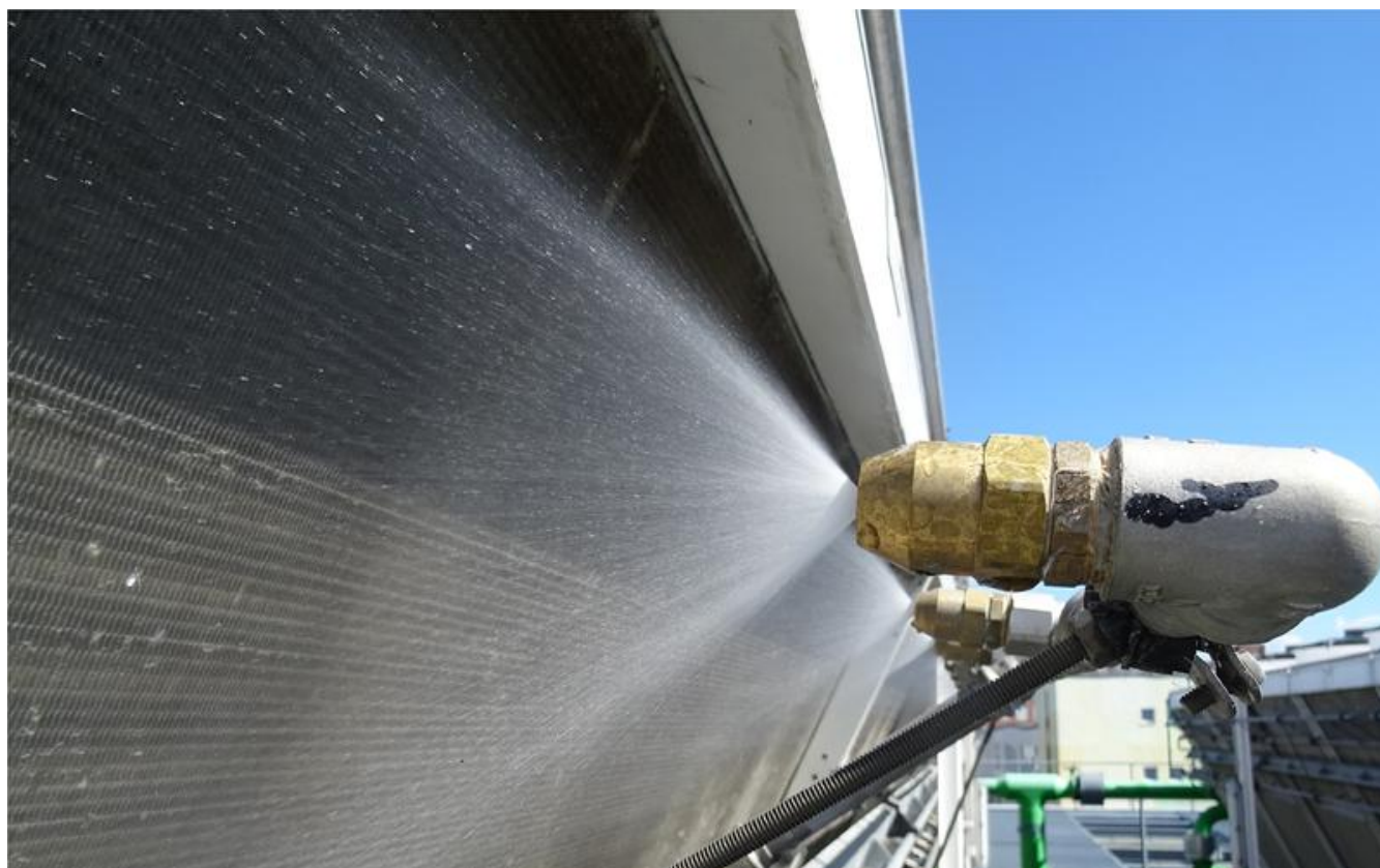
Besprühungsanlage Ventilator-Kühlturm ÖKOTEC Energiemanagement GmbH
