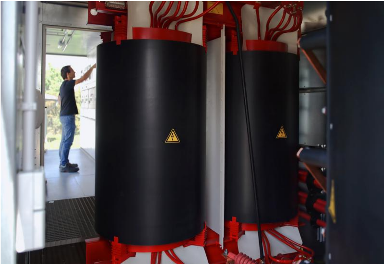
Innenansicht – Blick auf einen der drei Einphasen-Prüftransformatoren Fraunhofer IEE | Miliushchanka
