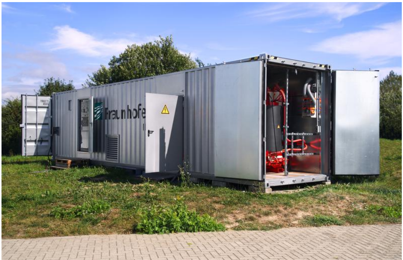
Die neue Prüfeinrichtung des Fraunhofer IEE zum Testen bzgl. OVRT / Spannungsüberhöhungen Fraunhofer IEE | Miliushchanka
