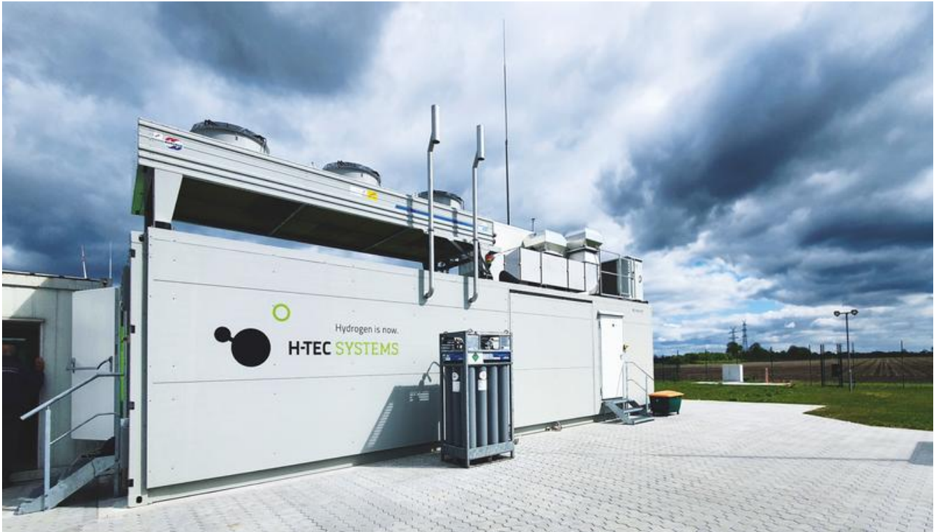
Elektrolyseur in Haurup bei Flensburg. H-TEC SYSTEMS GmbH
