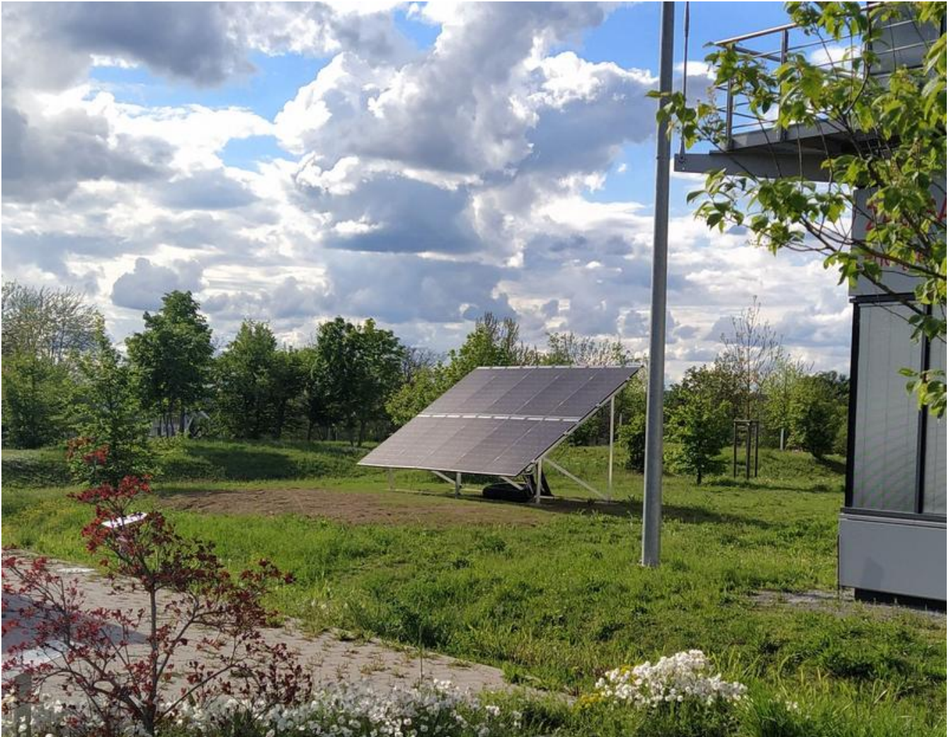
Abb. 2: PVT-Kollektoren als Wärme-, Kälte- u. Stromquelle für das RENBuild-System, auf dem Freiflächenversuchsgelände des CAE als Teil der Versuchsanlage. Als absolut lautlose Außeneinheit der Wärmepumpe. Für das Dach als auch in der Fassade einsetzbar. Foto: @CAE
