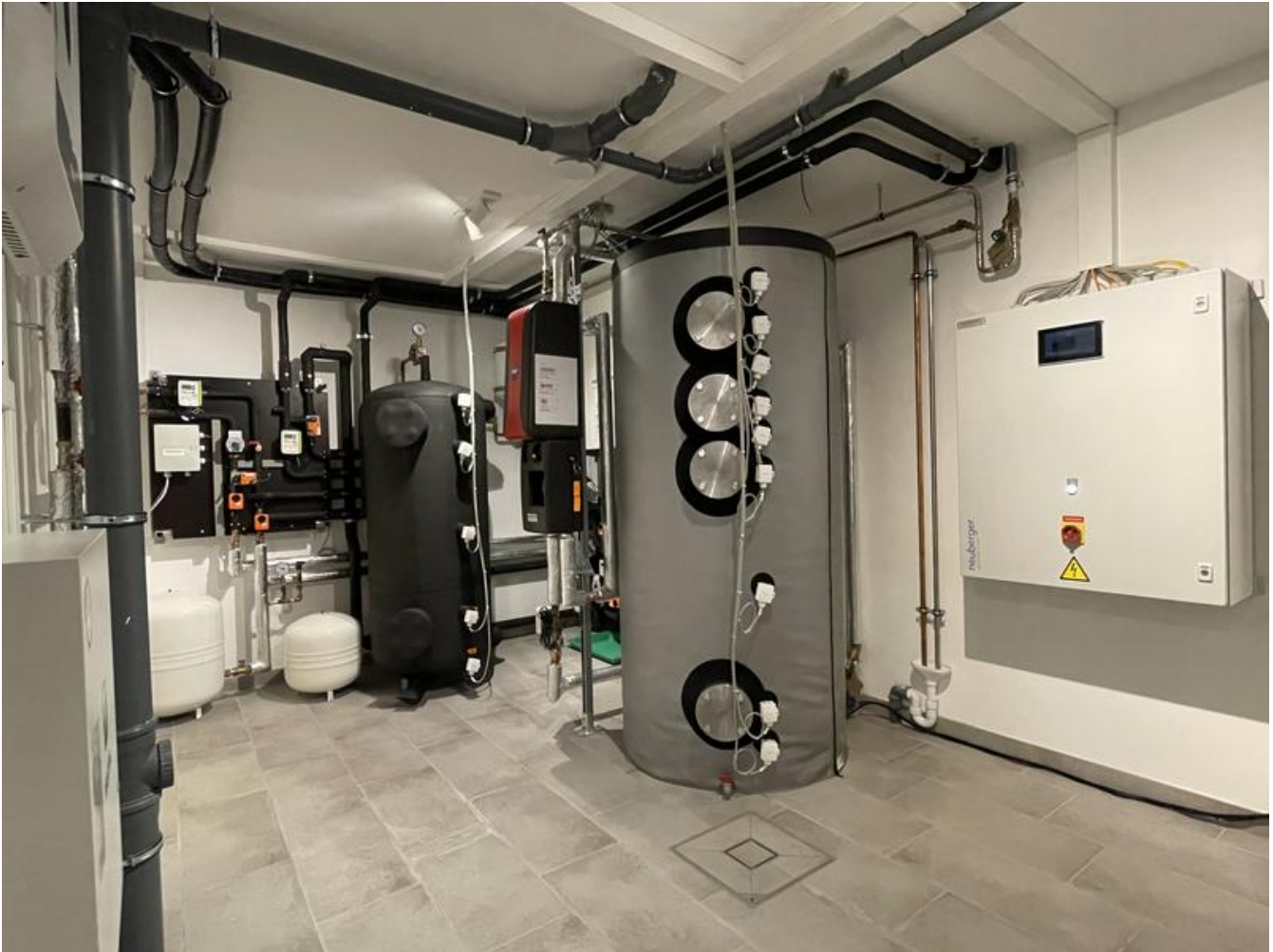
Abb. 1: Technikzentrale des RENBuild-Systems im Demowohngebäude des Projektpartners Hanse Haus mit Hochleistungshybridspeichern, optimierter Wärmepumpe und intelligenter Gebäudeautomation. Foto: @Hanse Haus
