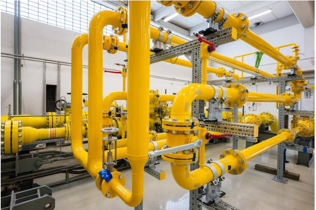
Wasserstoff-Teststand am Pilot-Wasserstoff-Netz von TransHyDE. Hier können Projektpartner untersuchen, wie sich Wasserstoff auf unterschiedliche Materialien auswirkt. RWE für TransHyDE
